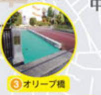
3 オリーブ橋 通行はできるが平成30年7月まで工事中(平成31年3月までの予定)
