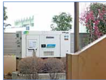
非常用発電機
