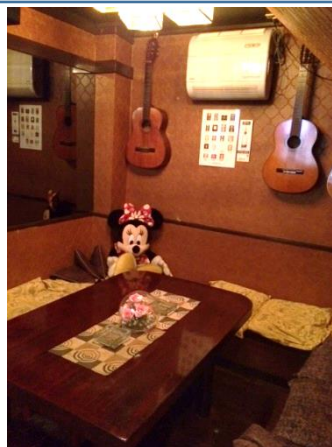
店内奥に空気清浄機を設置している。
