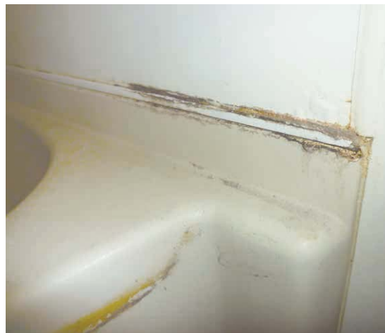
【浴室におけるカビ発生の様子】
