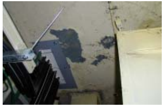
機械室天井のはがれた吹付けアスベスト
