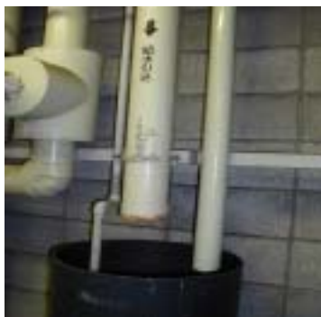
雑用水槽への補給水吐水口空間
