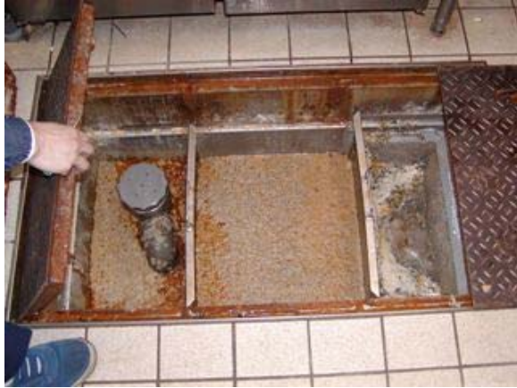
管理が不十分なグリース阻集器 右側から流入する。1 槽目のカゴには残飯が、 2、3 槽目には油がたまっている
