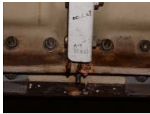
壁面が破損した貯水槽
