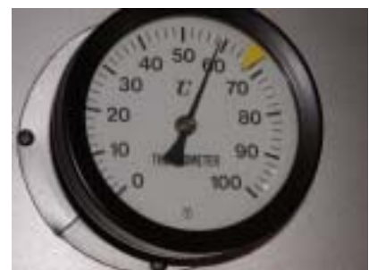
貯湯槽の温度計
