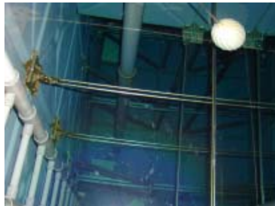
油膜が浮いている水面
