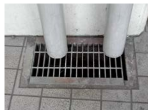
建物の排水ます
