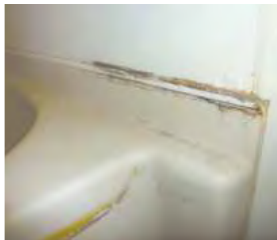
【浴室におけるカビ発生の様子】
