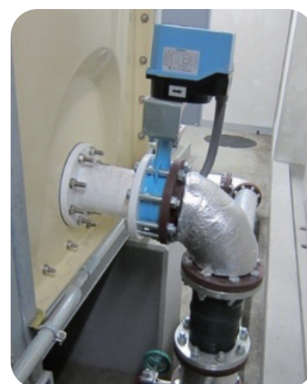
緊急遮断弁の設置例
