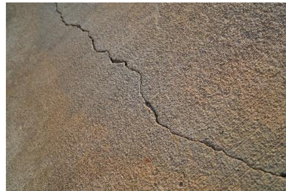
壁のひび割れ
