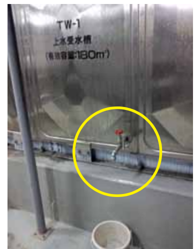
図-10 貯水槽の給水栓
