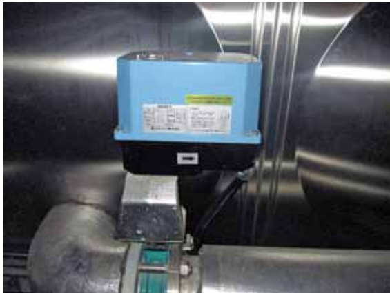
図-7 緊急遮断弁
