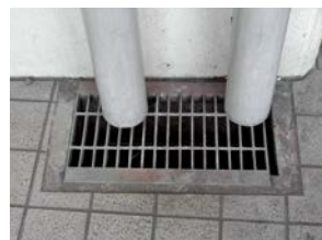
建物の排水ます
