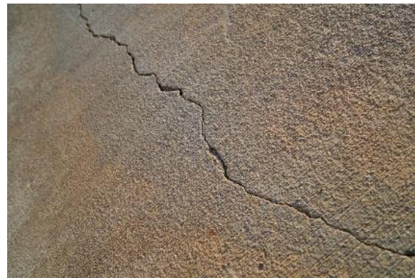
壁のひび割れ
