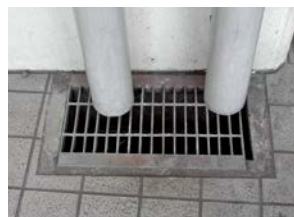
建物の排水ます
