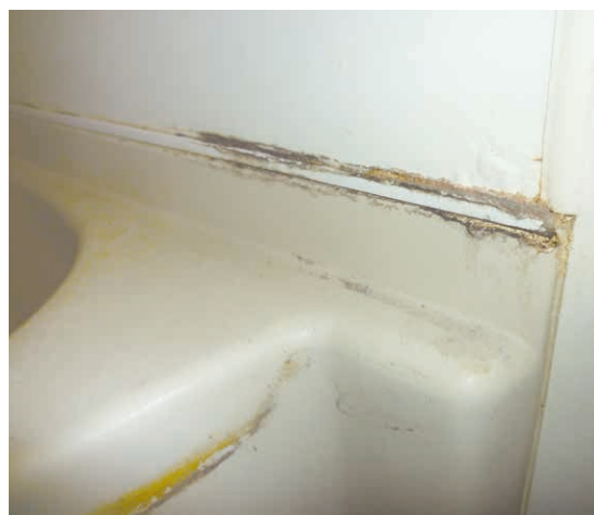
【浴室におけるカビ発生の様子】
