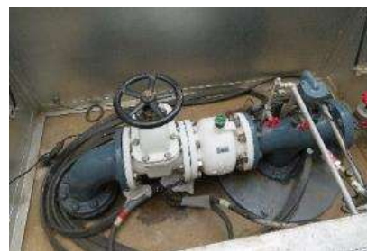
武蔵野市地下水井戸
