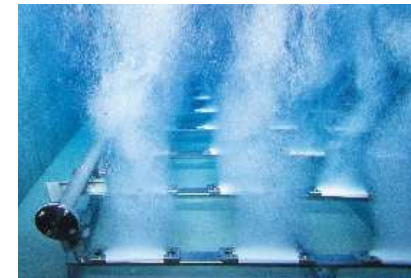
高度浄水処理（オゾン接触池）
