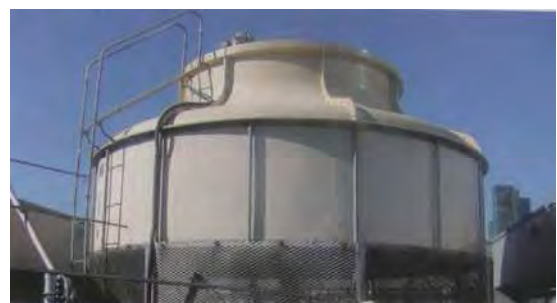
写真 2 冷却塔 (クーリングタワー)
